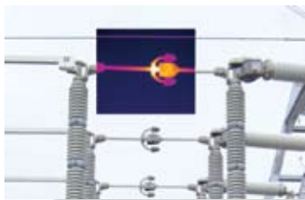
La funzione FLIR Picture-in-Picture fornisce una chiara immagine di quest'impianto ad alta tensione.
