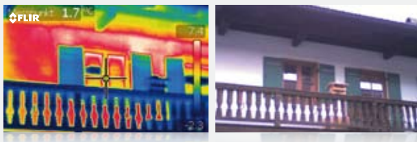
Isolamento scadente sopra la finestra del balcone
